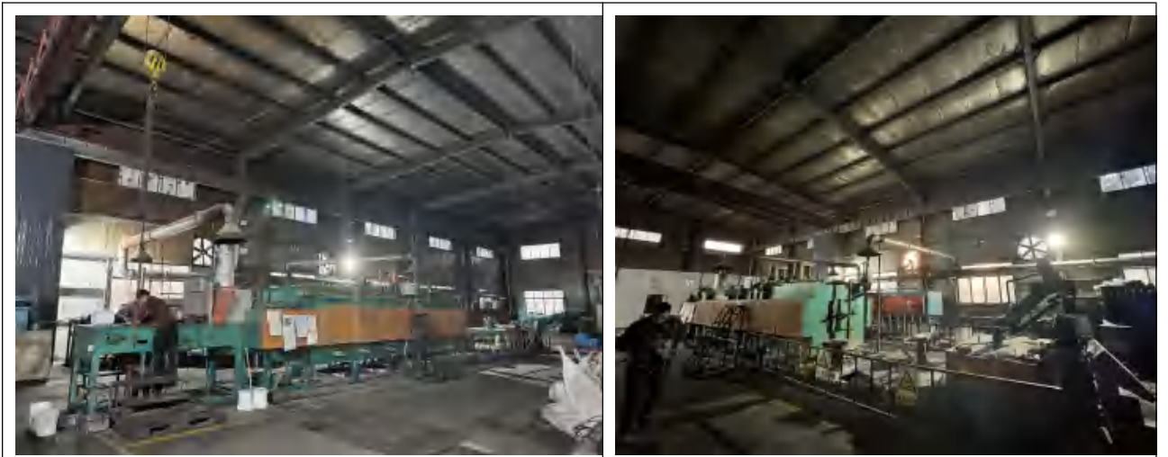
废气处理设施
