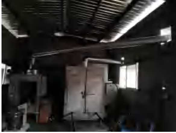
涂装线排气管道
