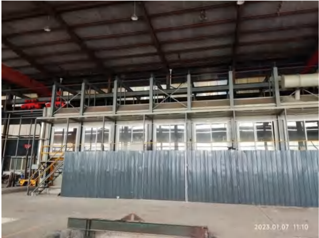
废气处理装置
