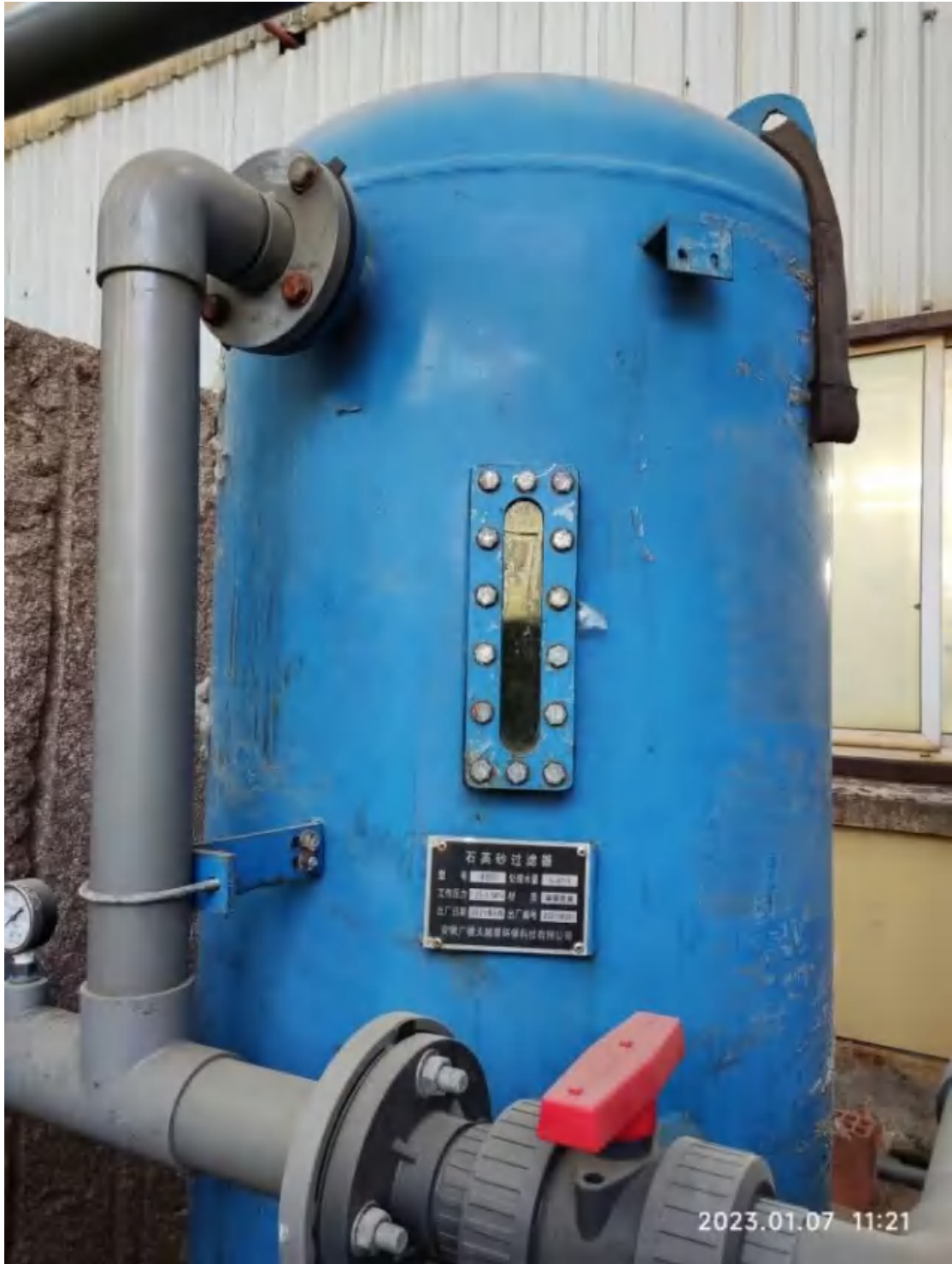
污水处理装置
